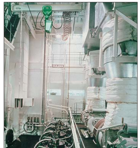
Einsatz im Schiffsmaschinenraum. JDN-PROFI 6 TI in einer Haspelketten-Laufkatze.
